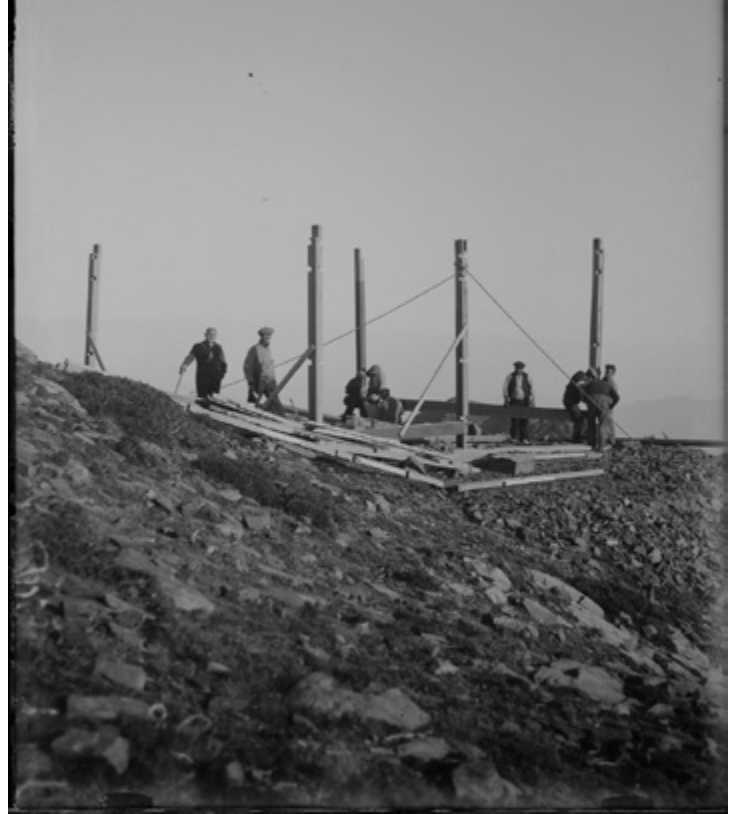
Inici de la construcció del xalet de fusta de l'Observatori meteorològic del Servei Meteorològic de Catalunya.
