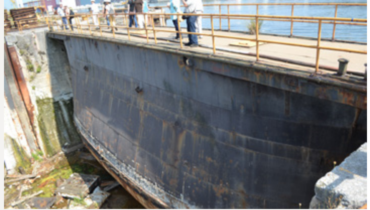
Caissón o barco puerta de cierre del dique N° 1, vista desde el interior del dique de 1890. Foto del autor, 2013
