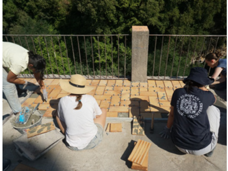
Grup de voluntariat treballant en la composició de la pavimentació exterior de Can Vinyoles
