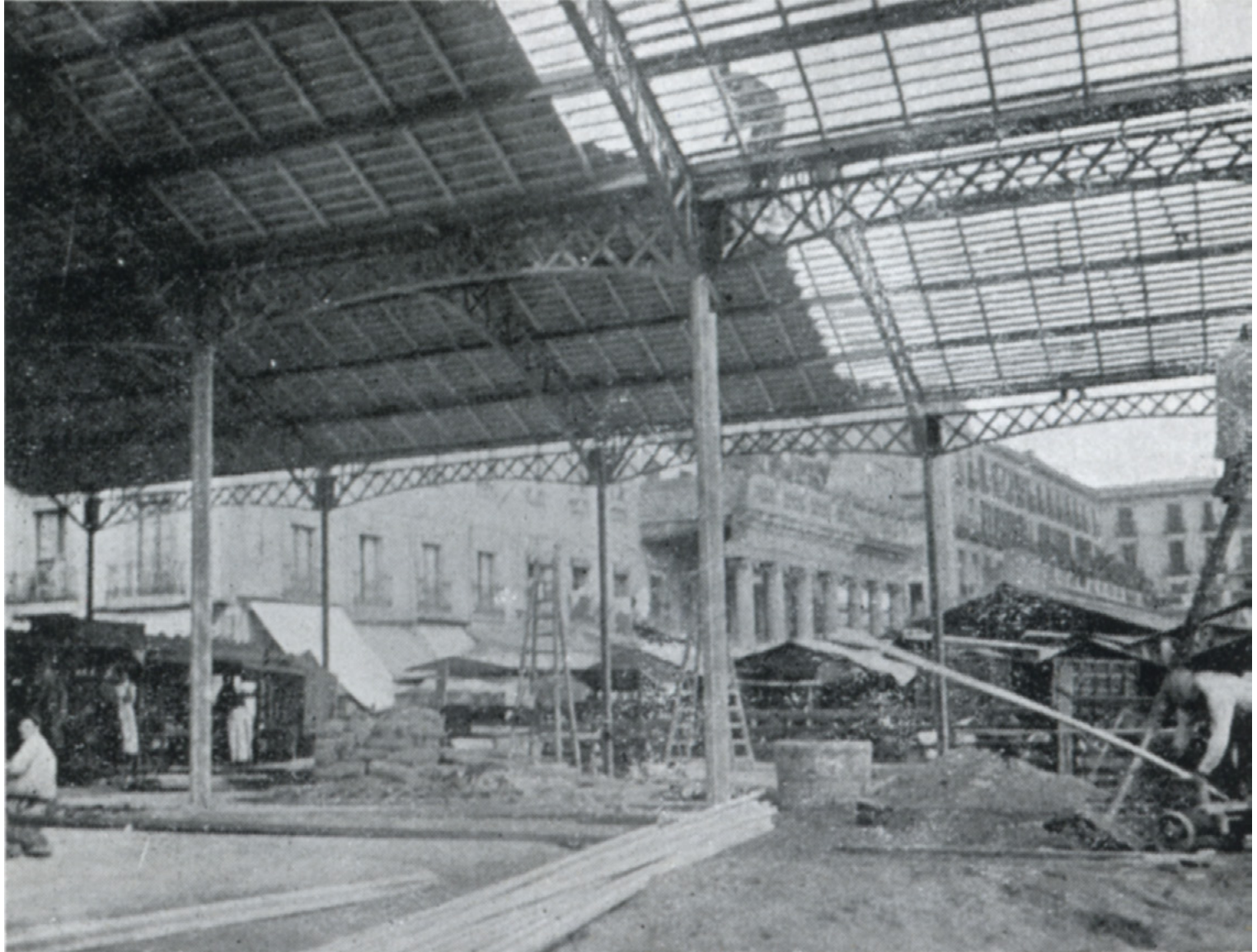
5. El mercat de la Boqueria durant les obres de construcció del coberts [Ponuario y catálogo : Torras - Herrería y Construcciones, 1915].
